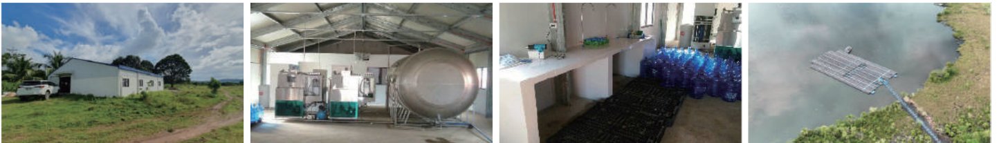
<필리핀 내 정수 처리 공정 및 태양광 시설 구축>
